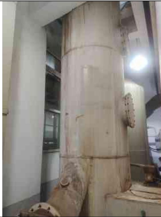
酸洗废气处理设施（1#碱喷淋）
