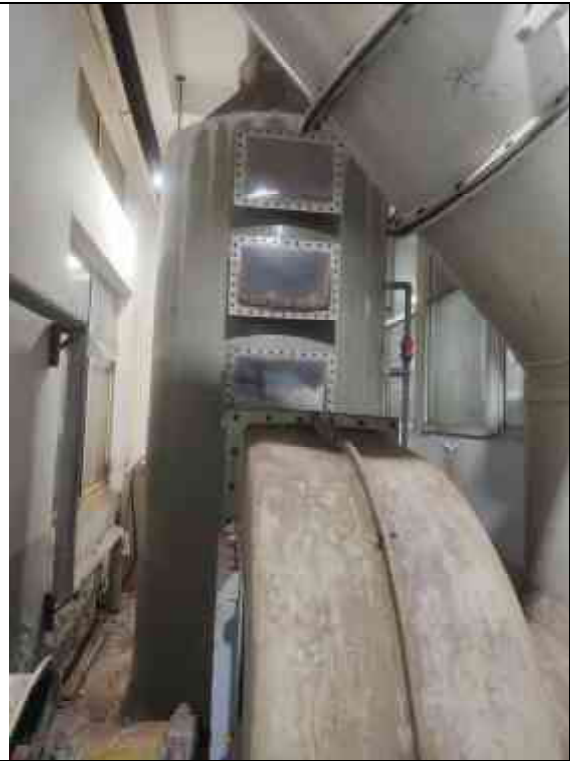
酸洗废气处理设施（2#碱喷淋）
