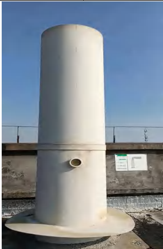
酸洗废气处理设施总排口
